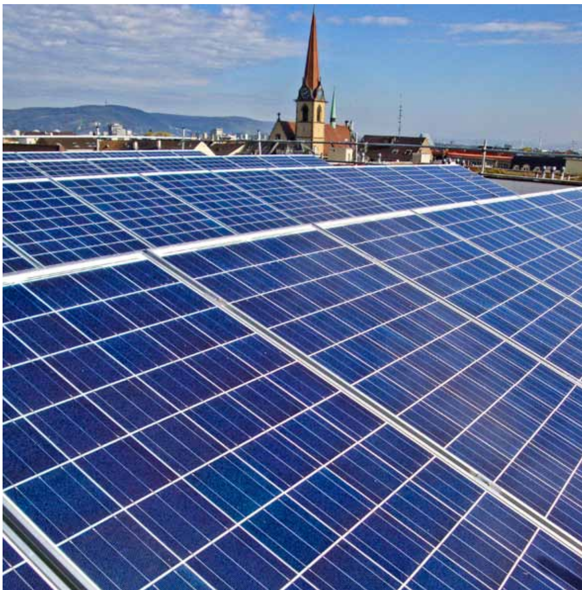
Neuste Photovoltaikanlage der Solarpar an der Dornacherstrasse 210 in Basel. Leistung 60 kWp
