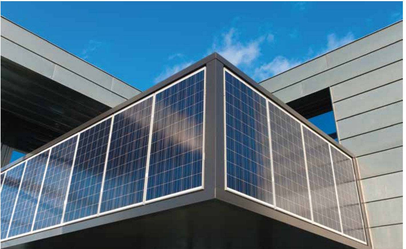
Solarspar baut in Luzern, Basel, Seuzach und Bonstetten neue Sonnenkraftwerke
