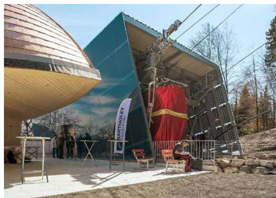
Die Photovoltaik-Anlage der Talstation liefert – ebenso wie jene der Bergstation – durchschnittlich 22, bei voller Sonneneinstrahlung sogar 42 Kilowattpeak.
